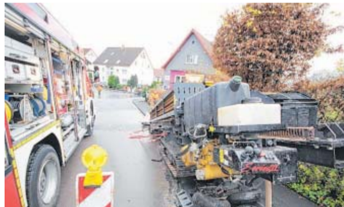
Unglücksmaschine: Mit dem Erdbohrer wurde die Gasleitung an der Pymonter Straße beschädigt.
