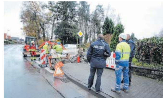
Unfallstelle: Unter diesem Fußweg wurde die Leitung beschädigt. Bauarbeiter graben, um an das Leck heranzukommen.
